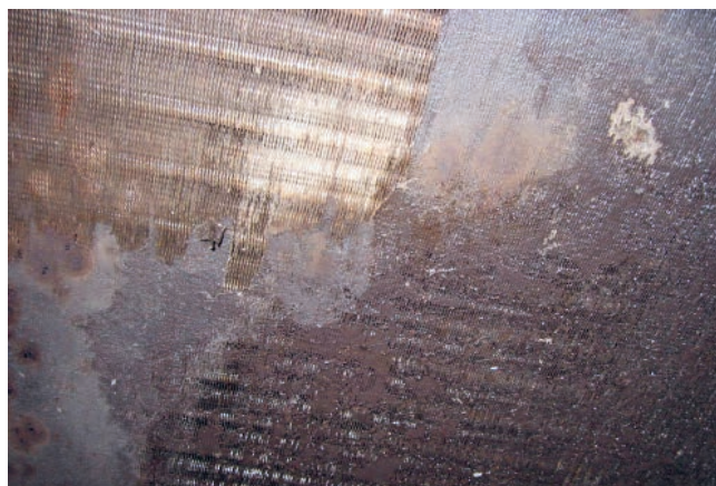
Photo: Refroidisseur d'air souillé, les lamelles se ferment lentement.
